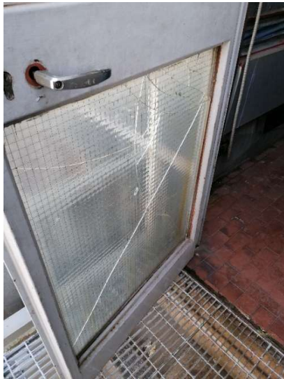
Foto: vetro danneggiato da sostituire
