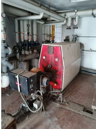
Foto: caldaia esistente da smaltire
