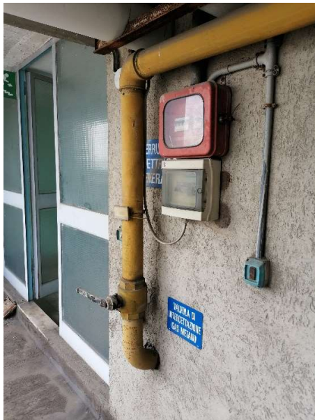
Foto: tubazione gas
