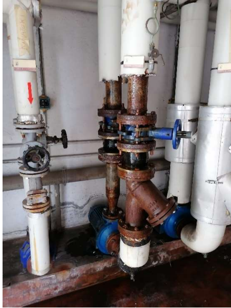
Foto: isolamenti da ripristinare
